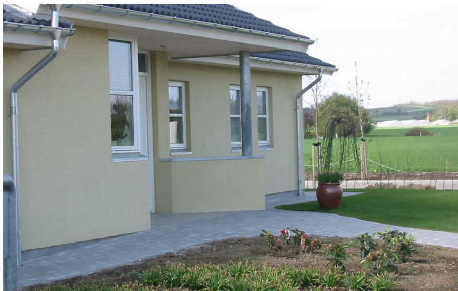
Figur 17. Fritliggende enfamiliehus udført med 150 mm fri sokkelhøjde og lokalt hævet terræn ved indgang, som er overdækket. Sundt princip, dog mangler rende mellem hævet terræn og sokkel. Mårslet.
