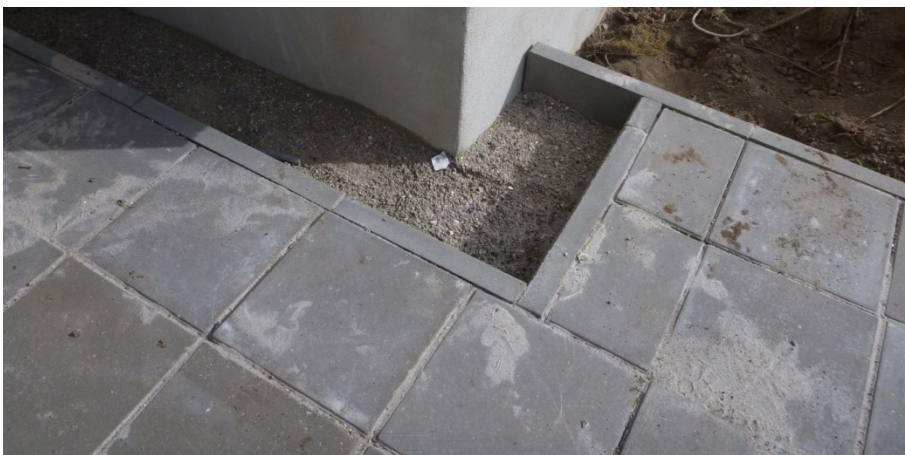
Figur 20. Render bør have afløb ud over terræn med jævne mellemrum, fx i enderne. Lukkede render, der kun afvander gennem dræn har ofte været anvendt, men de er ikke i overensstemmelse med Drænnormen. I dette tilfælde er det ret enkelt at åbne enden af rendern, så vandet kan afledes over terræn. Nyborg.
