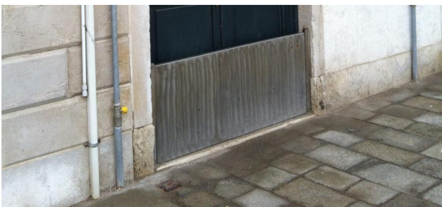
Figur 33. Oversvømmelsessikring. En 500 mm høj stålplade i skinne foran døren som sikring mod oversvømmelse. Niveaufri adgang kræver, at pladen løsnes og løftes op. Lignende løsninger er taget i brug i Danmark efter skybruddet i København 2011. Venedig, Italien.
