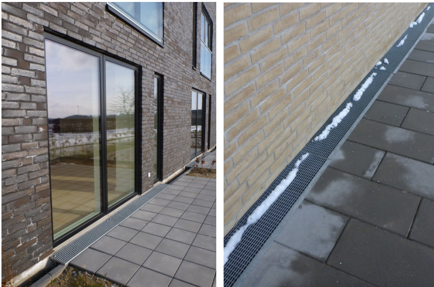
Figur 59. Rende overdækket med rist i det meste af terrassens bredde (til venstre) så man ikke træder ned i renden. Det tilgodeser ældre, udviklingshæmmede, gangbesværede, kørestolsbrugere, børn og mange andre. Til højre: adgangsareal i rækkehusbebyggelse sikret med rende med rist i hele arealets længde.
