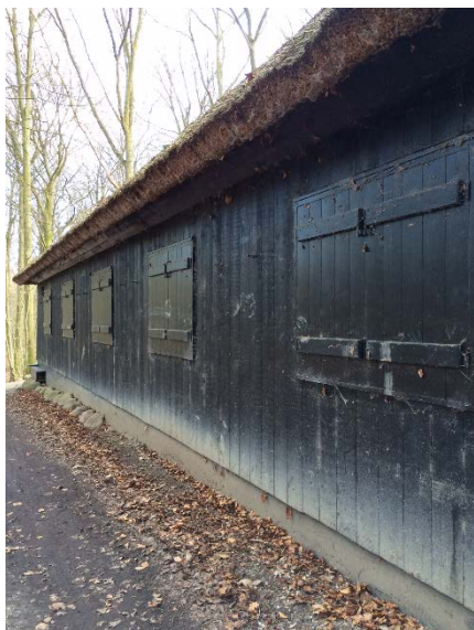
Figur 75. Eksempel på træfacade med jordpartikler fra opsprøjt op til 5-700 mm højde. Nordvendt facade. Belægning af jord. Der er ingen tagrende..
