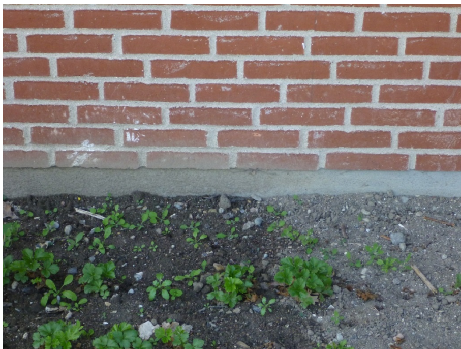
Figur 76. I venstre side: transport af jordpartikler op til ca. 200 mm højde. I højre side, hvor der er overdækket indgangsparti, er der ingen særlig "transporteffekt" af opsprøjt. Facaden er 3-etagers, beskyttet af tagrende og nordøstvendt.
